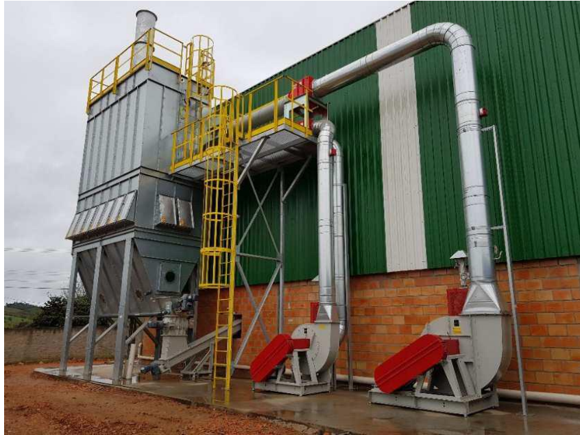
Figure 29 : Exemple de filtre à manche sur une installation de fabrication de granulés
